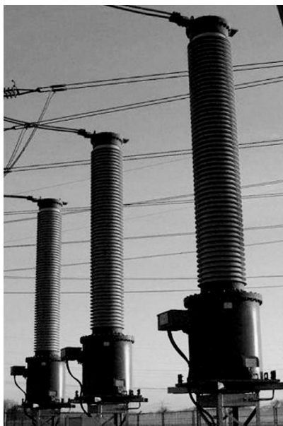
4.2.5. att. SF6 spriegummainis, tips: SVS (72.5 – 800 kV), ražotājs: Trench (Siemens Group).
